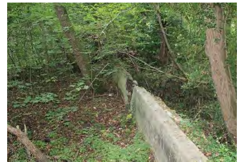
Photo 8 : mur à l'aval avec brèches
